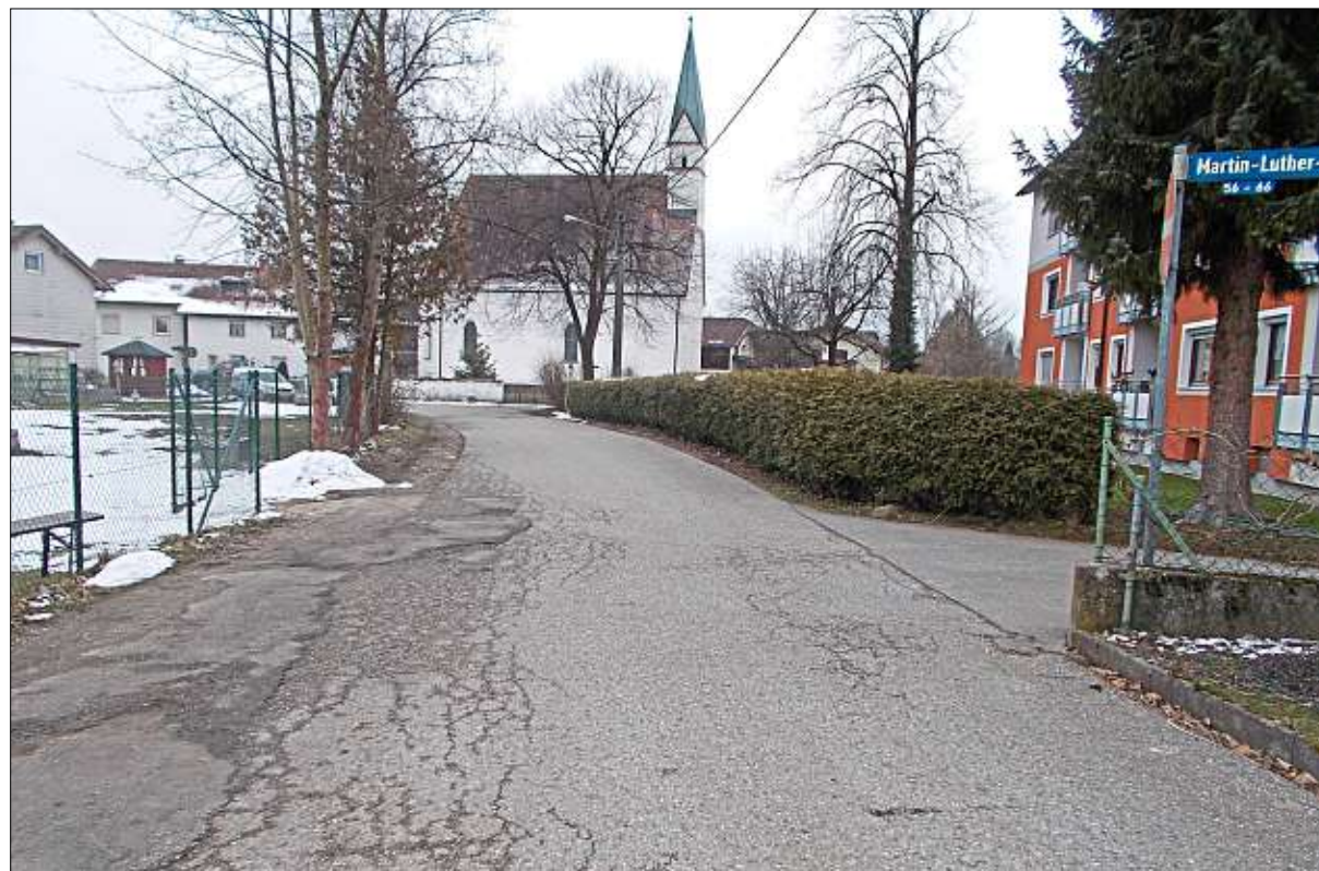
Der schadhafte Petersweg in dem Abschnitt, der demnächst seinen Endausbau erhalten soll.
